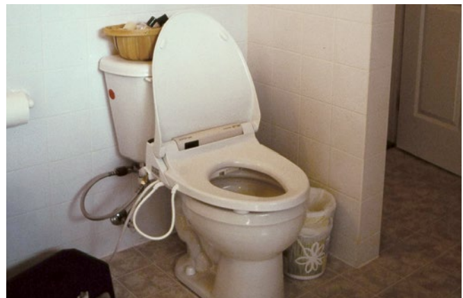
Figure 12: Toilette avec bidet intégré et séchoir Photo: Ron Wickman
